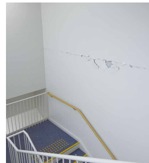
壁に亀裂が入り、破片が落下
