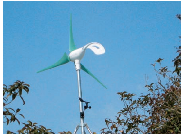
図1 理工学類共通棟の屋上に設置した小型風力発電機
