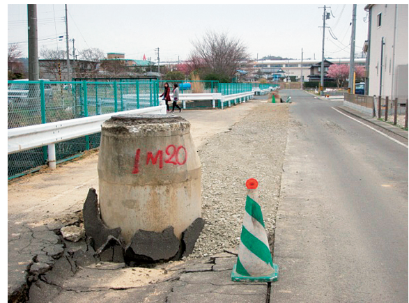
図5-2 白石市東町3丁目 マンホールの抜け上がり
